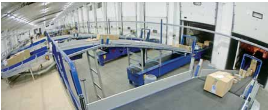
Leistung mit Reserven: Bis zu 7000 Pakete pro Stunde schafft die vollautomatische Sortieranlage im neuen Paket-Hub von General Parcel Cechy.
