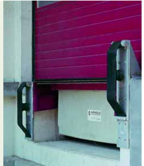
Federleicht angedockt: Federstahlpuffer verhindern Schäden an Lkw und Gebäude.
